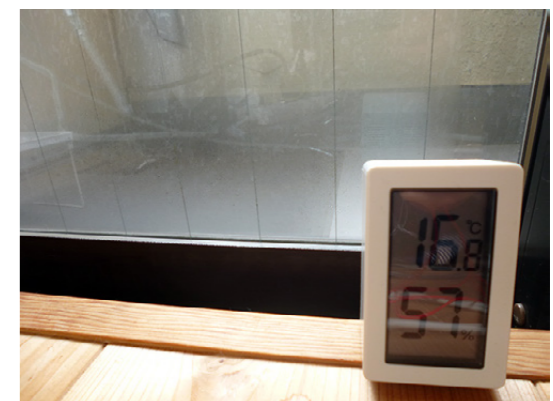
12月のある朝。掃き出しサッシ下部ガラス部分に結露が発生しています
