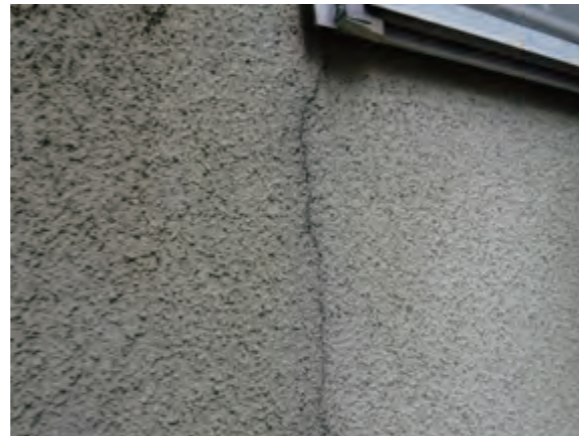
外壁の亀裂をほっておくと雨が内部に浸透します
