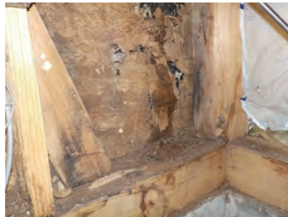
長年の雨漏りが壁の下地を腐朽させています
